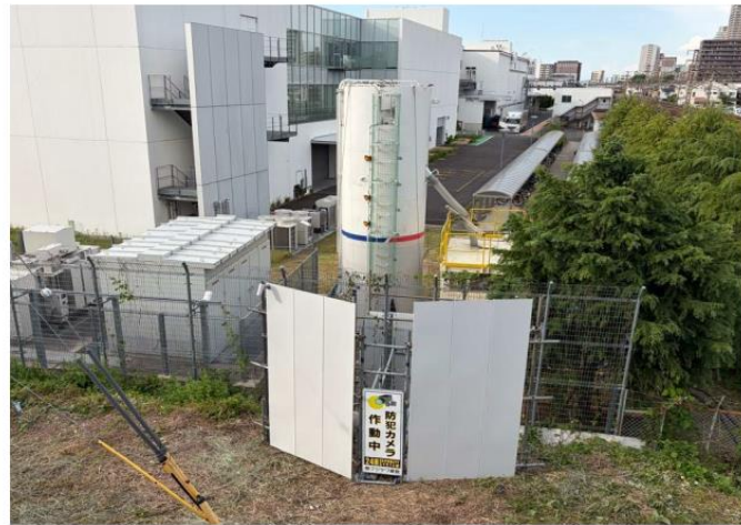
注入プラント(写真)
