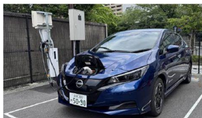
公用車の電動化 EV急速充電器
