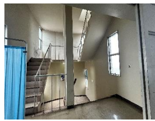
エレベーターが未設置
