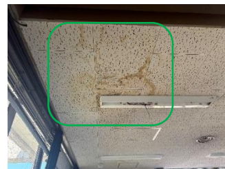
天井の雨漏り
