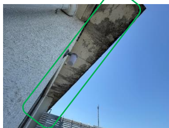
仕上げ材の剥離
