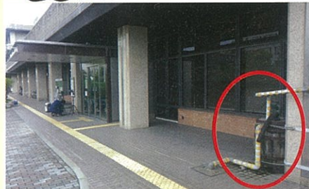
滋賀県南部合同庁舎における雨水貯留タンク(草津市)
