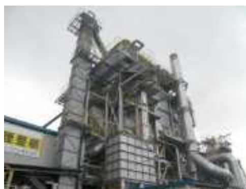
木質バイオマス発電所
